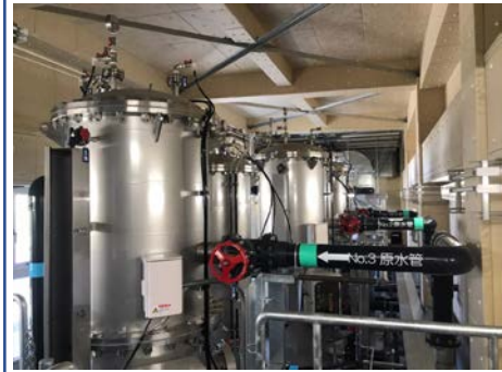
東京都大田区 呑川河川浄化設備 本導入
