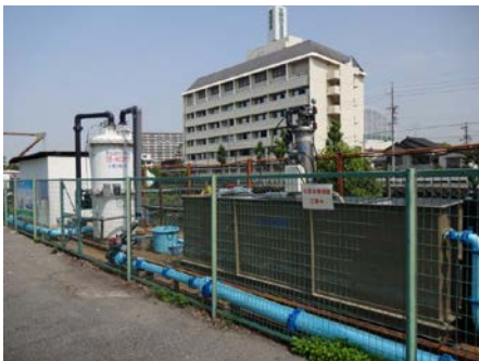
名古屋 新堀川 浄化実証試験
