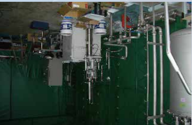
焼酎廃液処理装置圧力制御部
