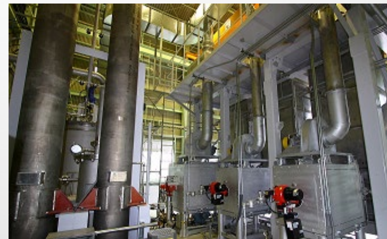
焼酎廃液処理装置(20t/day)
