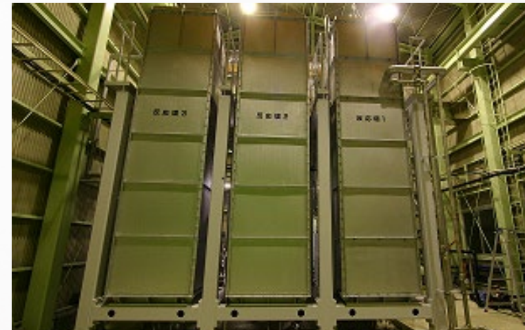
焼酎廃液処理装置の反応塔部 (20t/day)
