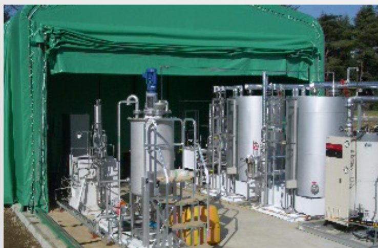
装置全景写真(15t/day)
