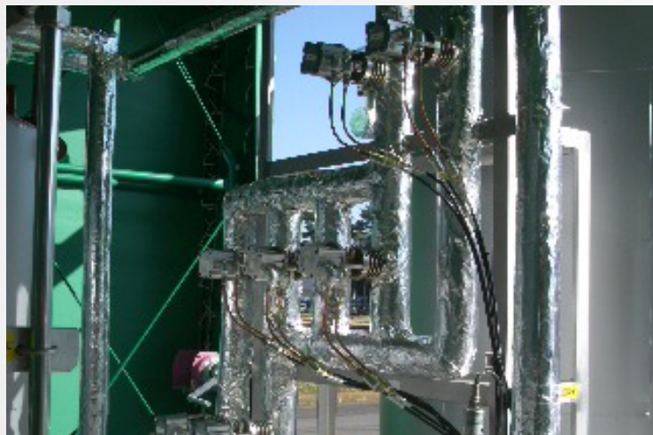
圧力制御ノズル・バルブ群
