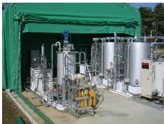
写真 12; 装置全景写真(15t/day)
