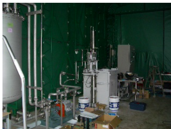
写真 13; 高圧スラリーポンプ
